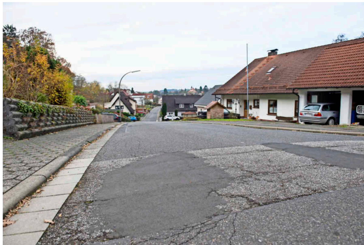
Stein des Anstoßes: Nach dem Streit um die Straßenausbaubeiträge in der Straße »Zur Lauterhecke« hat der Sailauer Gemeinderat jetzt beantragt, das Ratsbegehren zu diesem Thema auf den Termin der Bundestagswahl 2017 zu legen.
